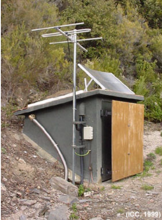
Vista en detall de la caseta instrumental, antics pannells solars i antiga antena telemètrica.
