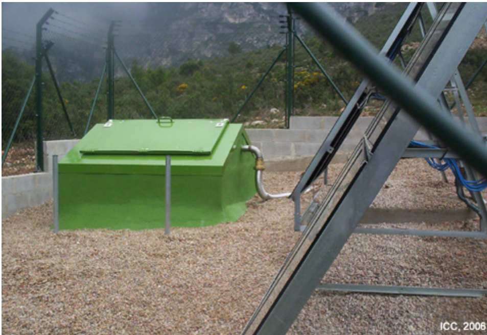
Detall de la coberta del pou sísmic i estructura dels panells solars en primer pla.
