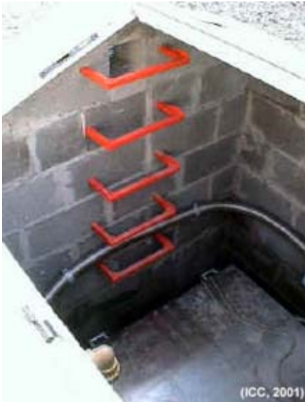
Vista de detall de la tapadora del pou sísmic i escala d'accés a la caixa d'acer on se situa el sensor.
