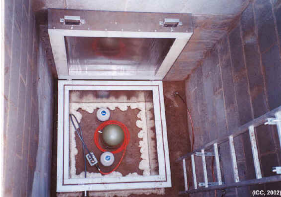
Vista en detall del pou sísmic i l'escala d'accés a la caixa d'acer on es localitza el sensor.
