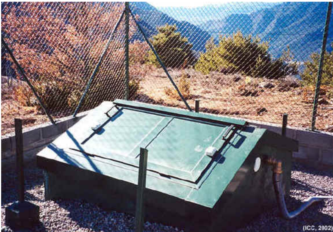
Vista en detall de la tapadora del pou sísmic.
